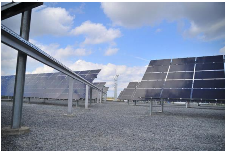
Солнечная электростанция в Яковлевском районе
