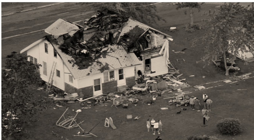
Рисунок 1 – Разрушенный дом в частном секторе г. Барнаул. Июль 2012 г.
