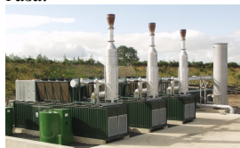
Фрагмент крупнейшей в Ирландии станции по переработке свалочного газа Arthurstown (Ловецкая)
