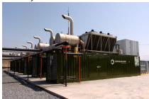
Комплекс по переработке свалочного газа в мексиканском Монтеррее мощностью 7 МВт
