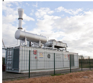
Станция по переработке свалочного газа в Орше (Беларусь)
