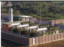
Установка по сжиганию свалочного газа под Дурбаном (ЮАР) мощностью 4 МВт
