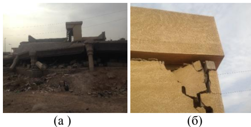
Рисунок 3- Коллапс передней части здания и коллапс стенах бетонных блоков из-за сильного сдвига в результате взрыва
