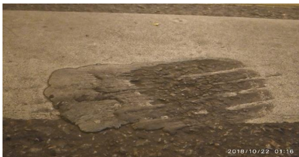
Рисунок 6 - Деформация и загрязнение линий дорожной разметки
