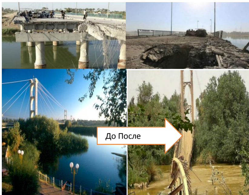
Рисунок 5 - Состояние уничтоженных в ходе боевых действий дорожных сооружений из-за войны
