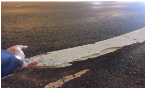
Рисунок 8 - Потеря адгезии разметочного материала с поверхностью дорожного покрытия
