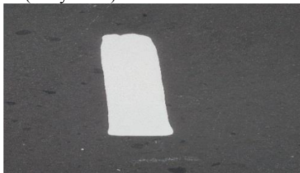
Рисунок 3 - Дефекты геометрии линий дорожной разметки
