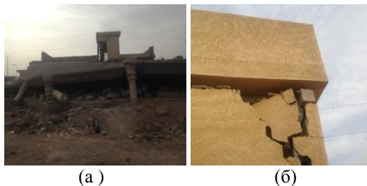
Рисунок 3- Коллапс передней части здания и коллапс стен бетонных блоков из-за сильного сдвига в результате взрыва
