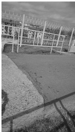
Рисунок 9в – Дефект на стыке бетонного и асфальтобетонного покрытий (трещины) на 147 метре полигона
