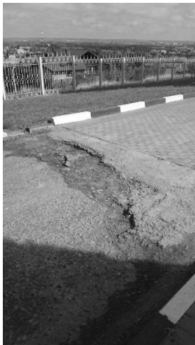
Рисунок 9ж – Дефект асфальтобетонного покрытия (отслоение дорожного полотна) на 290 метре полигона
