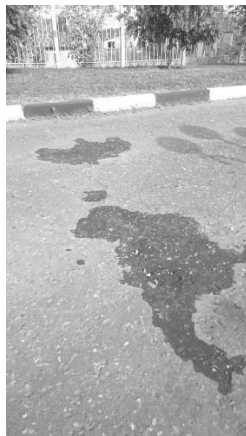
Рисунок 9д – Дефект асфальтобетонного покрытия (отслоение дорожного полотна) на 235 метре полигона
