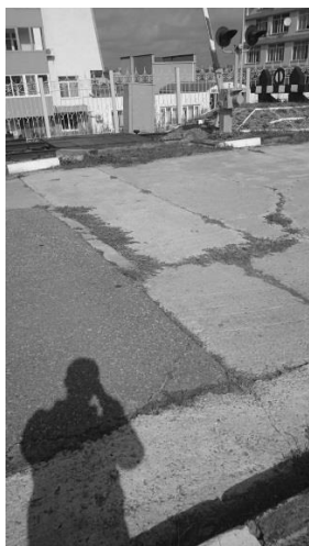
Рисунок 9а – Дефект на стыке бетонного и асфальтобетонного покрытий (трещины) на 47 метре полигона
