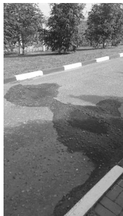
Рисунок 9е – Дефект асфальтобетонного покрытия (трещины и ямы) на 274 метре полигона
