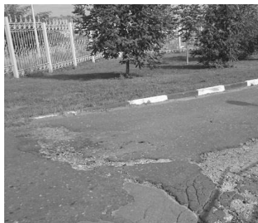
Рисунок 9г – Дефект асфальтобетонного покрытия (отслоение дорожного полотна) на 200 метре полигона
