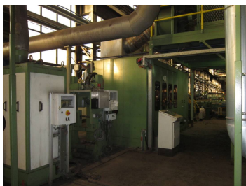
Рисунок 2 – Линия окраски труб с использованием лака УФ-отверждения
